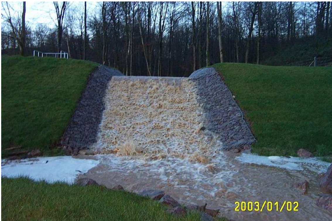
Déversoir rectangulaire en gabion
