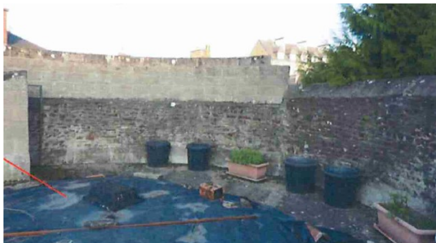
Photo du rapport d'expertise du 18/10/2010 (dalle de béton en haut de l'ouvrage)
